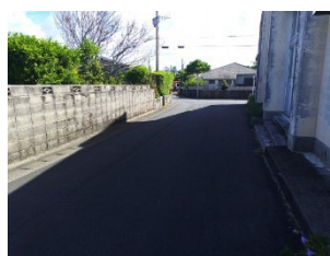
危険なブロック塀
