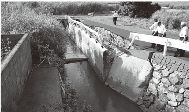
崩壊した用水路(塩道)
