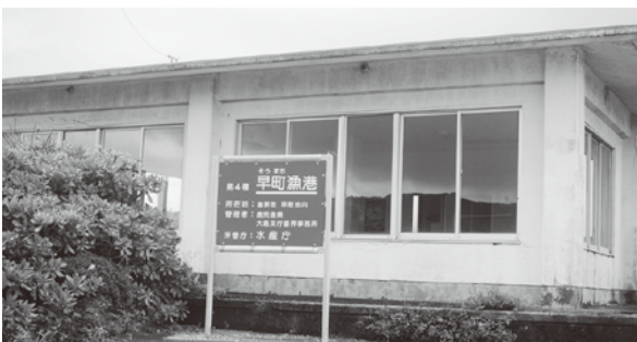
老朽化した早町漁港待合所
