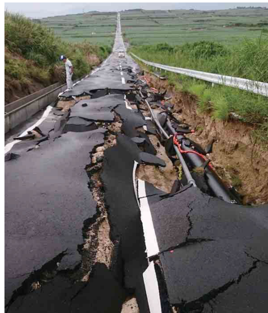
▲破壊された道路
